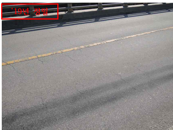
교면포장 아스콘 손상
